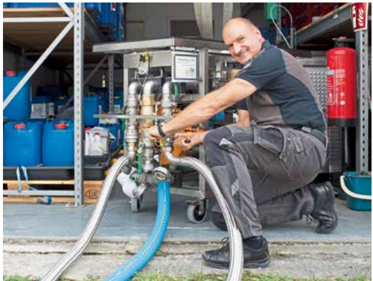
Stefan Oetzel, Inhaber der Oetzel Wasserhygiene GmbH, mit seiner sp1/BS in seinem Lagerraum im Nordosten von München.
